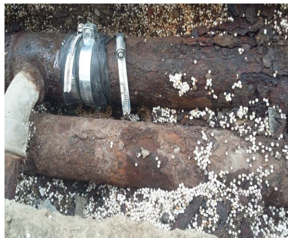
Figura 89 - Tubos de ferro de aquecimento com 2,5'' com ferrugem que foram substituídos com carácter de urgência
