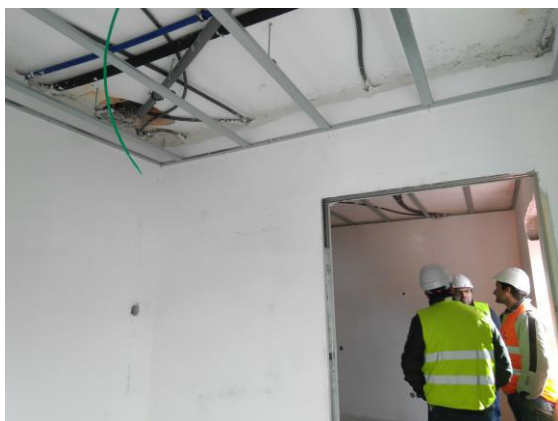
Figura 61 - Necessidade de colocação de tetos falsos em pladur
